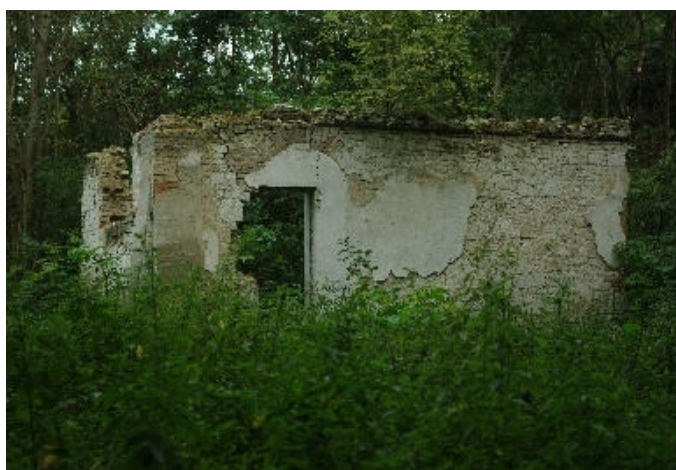
Pozostałości stajni cugowej zniszczonej pożarem.
